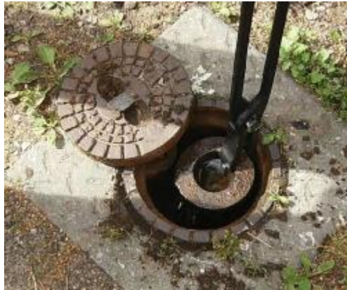
Σχήμα 7: Κάλυμμα αγωγού επιθεώρησης
